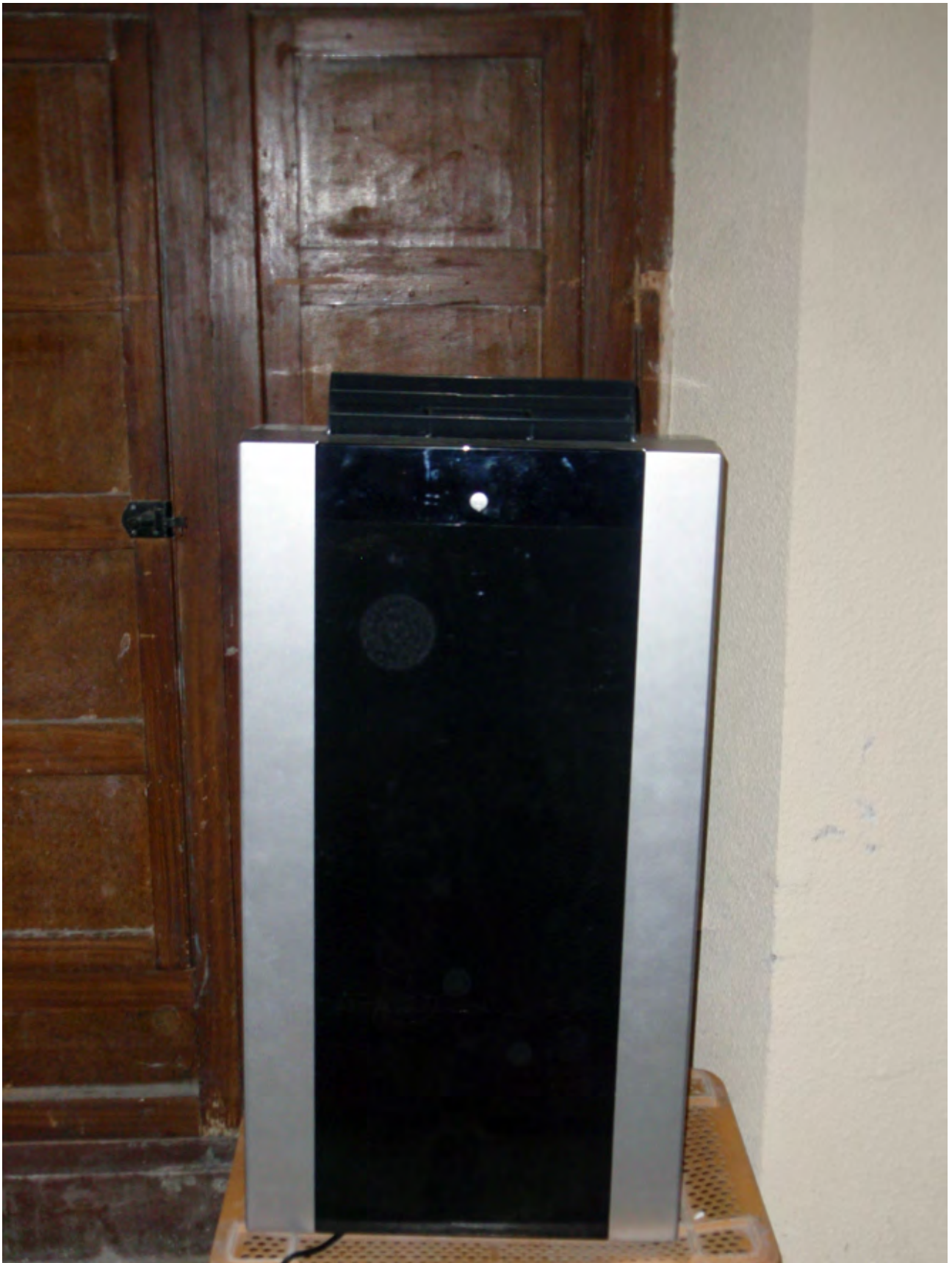
Làmina 7. Climatitzador instal·lat a la secció història de l'Arxiu Municipal situat a la casa de la família Rico.
