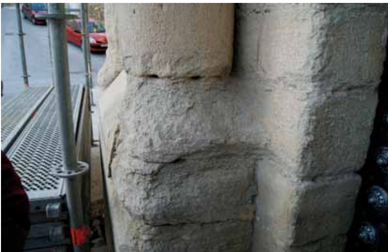
Láminas 10-12. Aspecto del deterioro en la portada principal.
